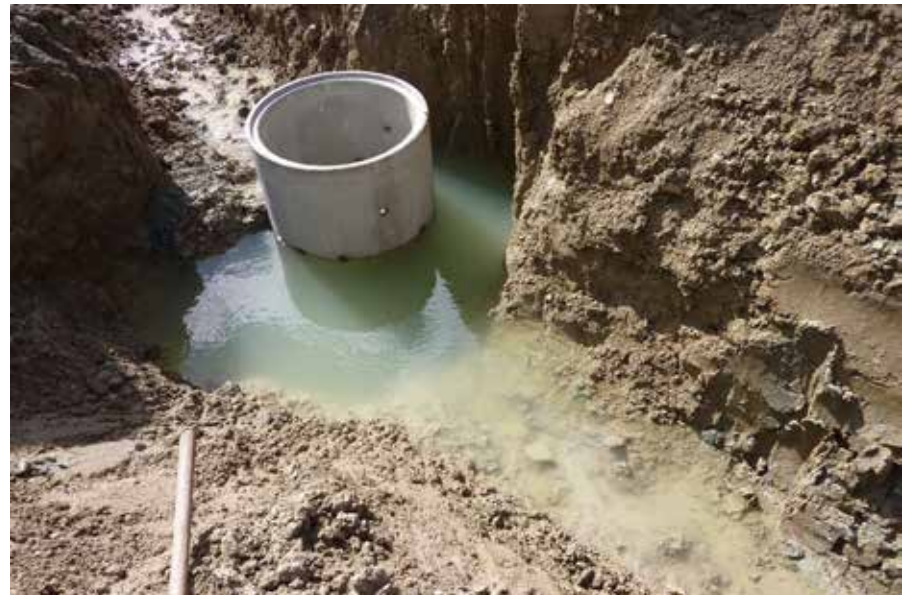
captage de source
